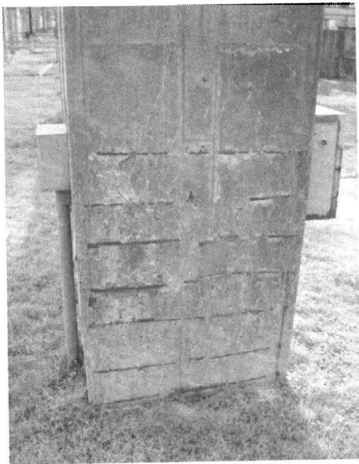
图 1.1 箍筋暴露的混凝土柱
