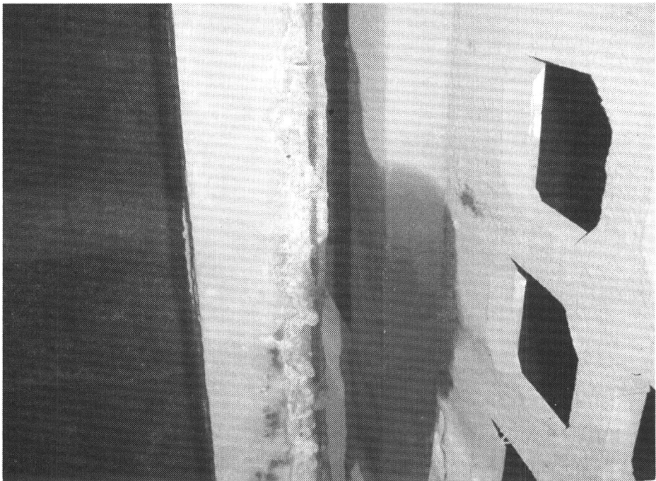
图 1.5 边角剥落且露筋严重的混凝土柱
