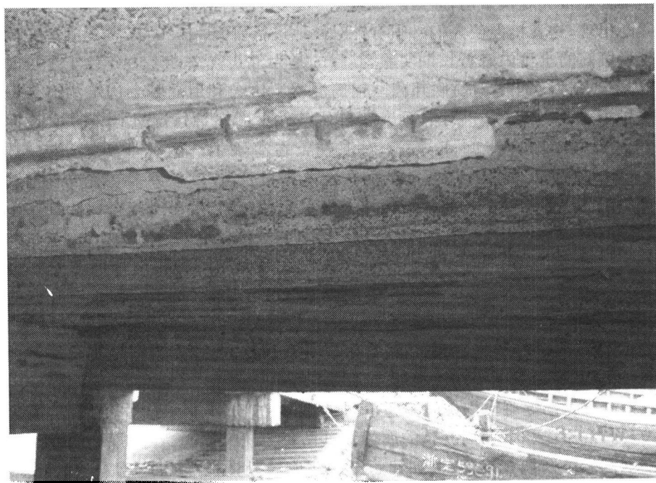
图 1.8 露筋严重的混凝土构件
