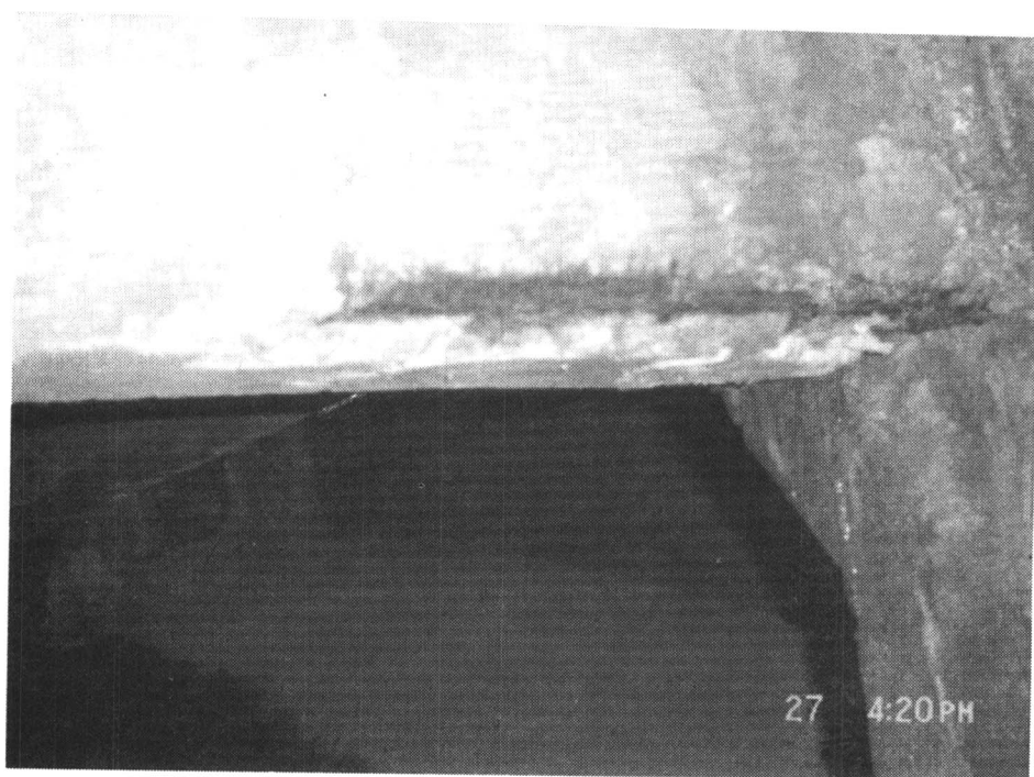
图 1.6 边角剥落且露筋严重的混凝土盖梁
