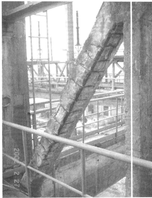
图 1.4 露筋严重的混凝土桁架
