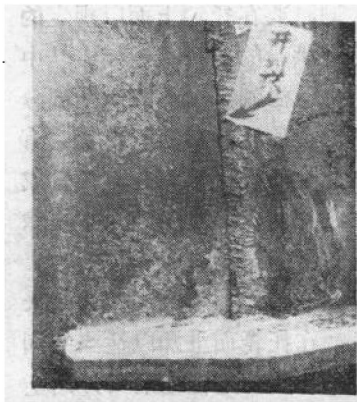
图 1 窑筒体焊缝处开裂
