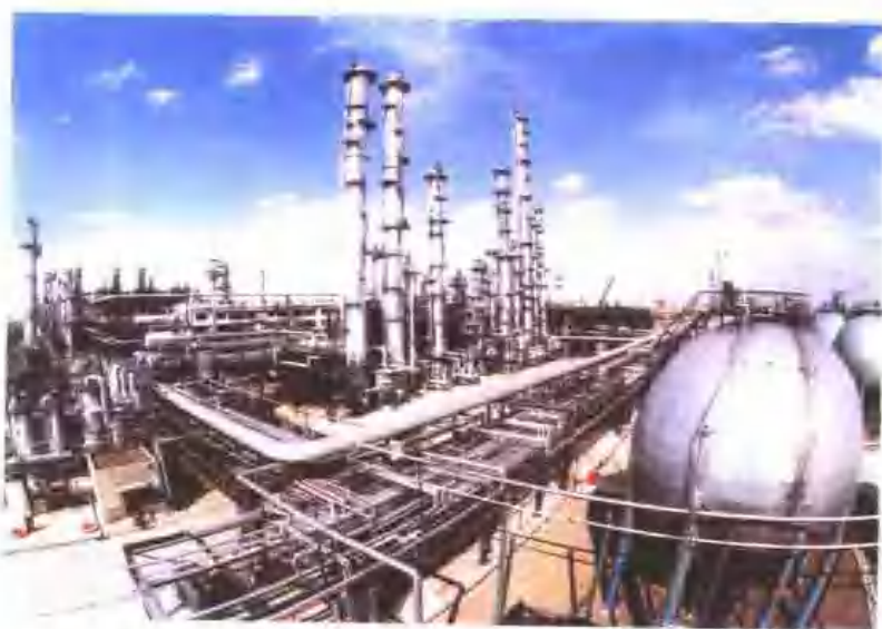
大庆石化分公司依靠科技创新，优化生产方案，使装置长周期、大负荷生产水平达到新的高度 (廖和明 摄)
