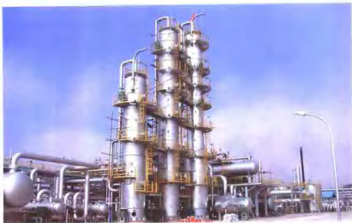
在油气田开发建设中，新建产能的整体效益进一步提高。图为长庆油田分公司第一采气厂净化厂 (武铭 摄)
