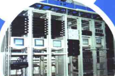
● 寻呼公司先进的机房设备
