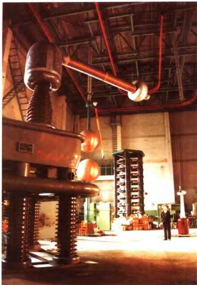
高压试验大厅
