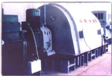
13 500kW 大型同步电动机组
