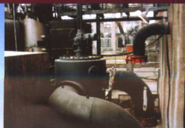
正在运行中的自动反冲洗滤网装置
