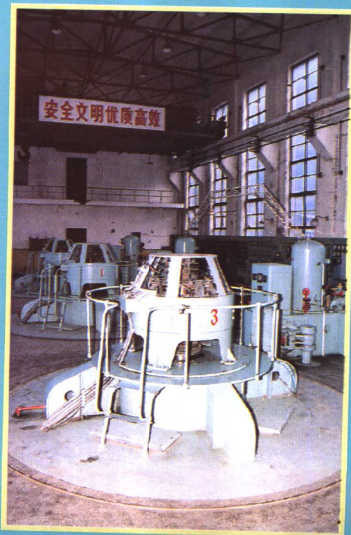
侯壁电站运行机组
