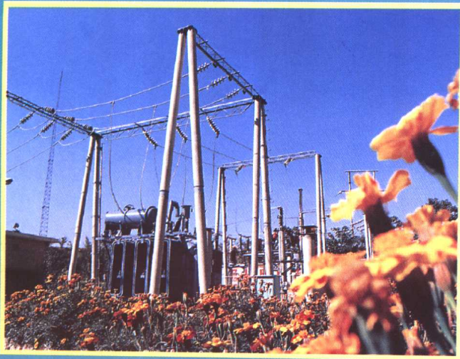
花园式的朔头 110 千伏变电站
