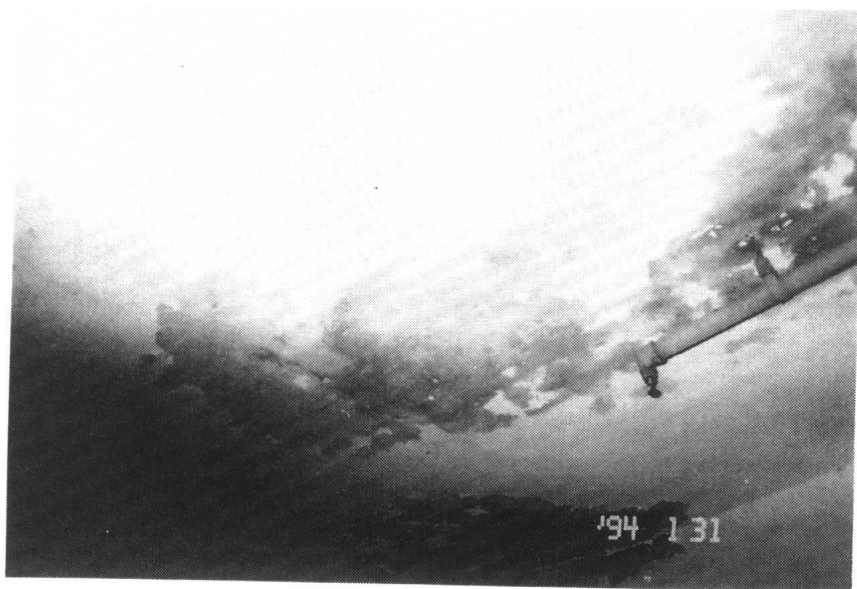
林口國宅一期一、三標地下商場頂版漏水現象(相片八)
