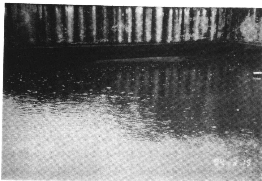
省立台北醫院屋頂PU防水層(相片一) 雖然積水盈寸，並未有滲漏情形
