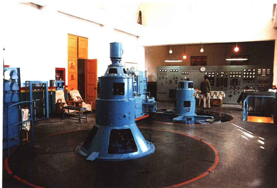
◆甘肃大夏河白土坡水电站厂房发电机层
