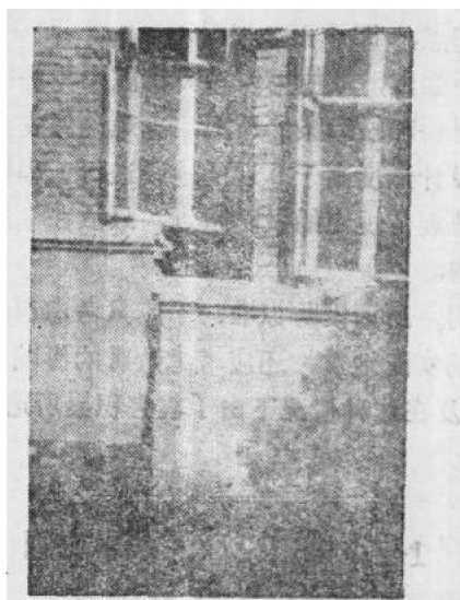
图 1-1 建筑在故河道上的房屋，地震后因地基滑移造成上部建筑物的开裂
