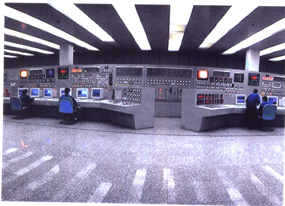
法国电力公司在山东的火力发电项目。
