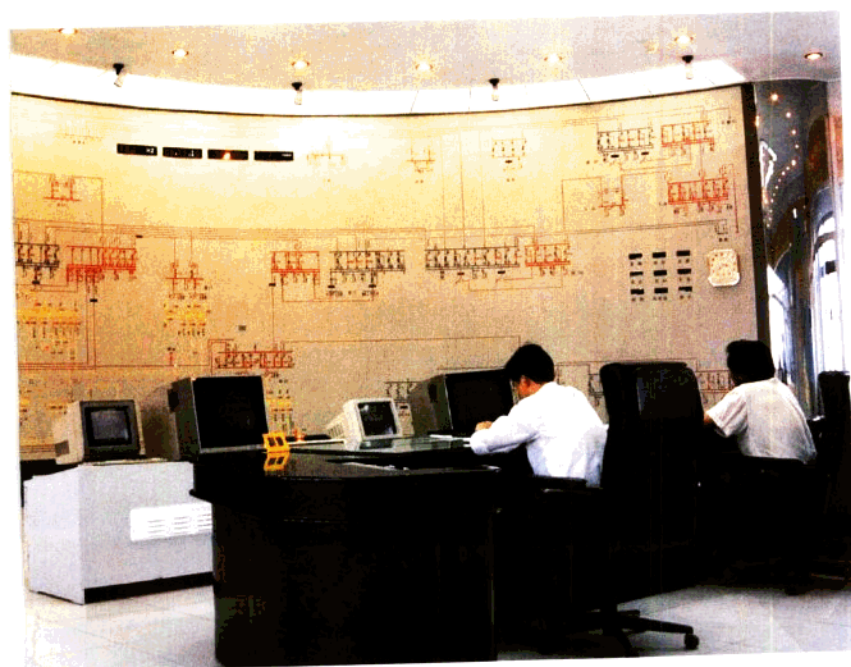
苏州供电局地区调度室
