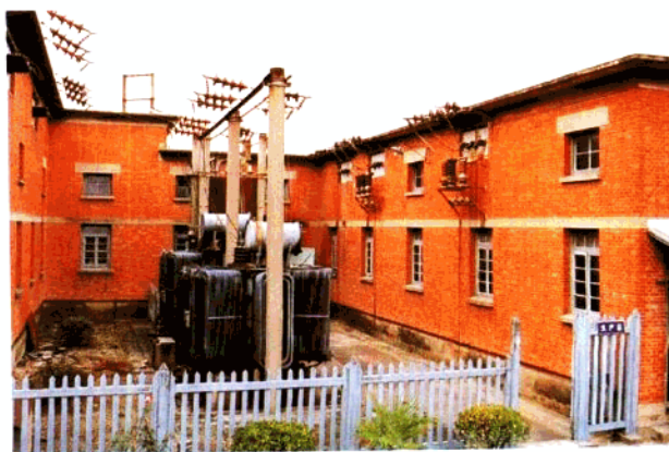
35 千伏许关变电站(1958)
