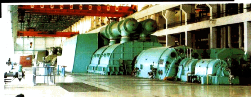
常熟发电厂发电车间
