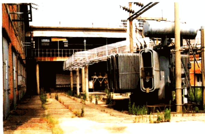
35 千伏胥门变电站(1958)
