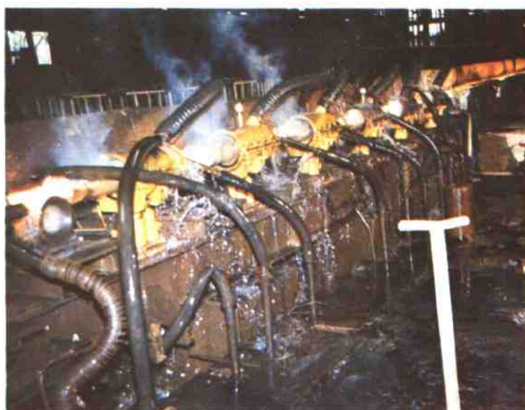
钢管连续控制冷却装置
