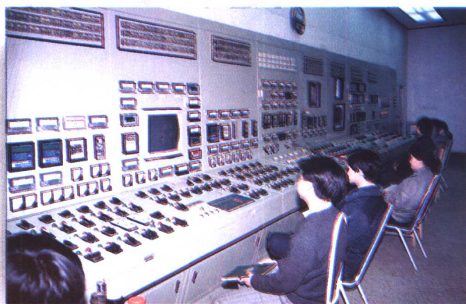
电厂集中控制室
