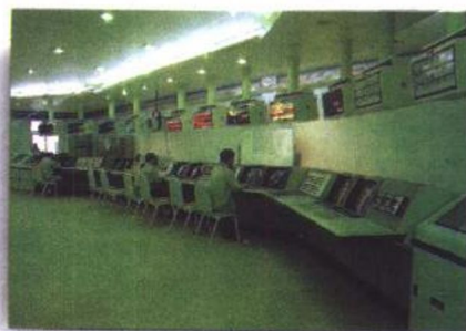
北京东方化工厂乙烯裂解装置主控室
