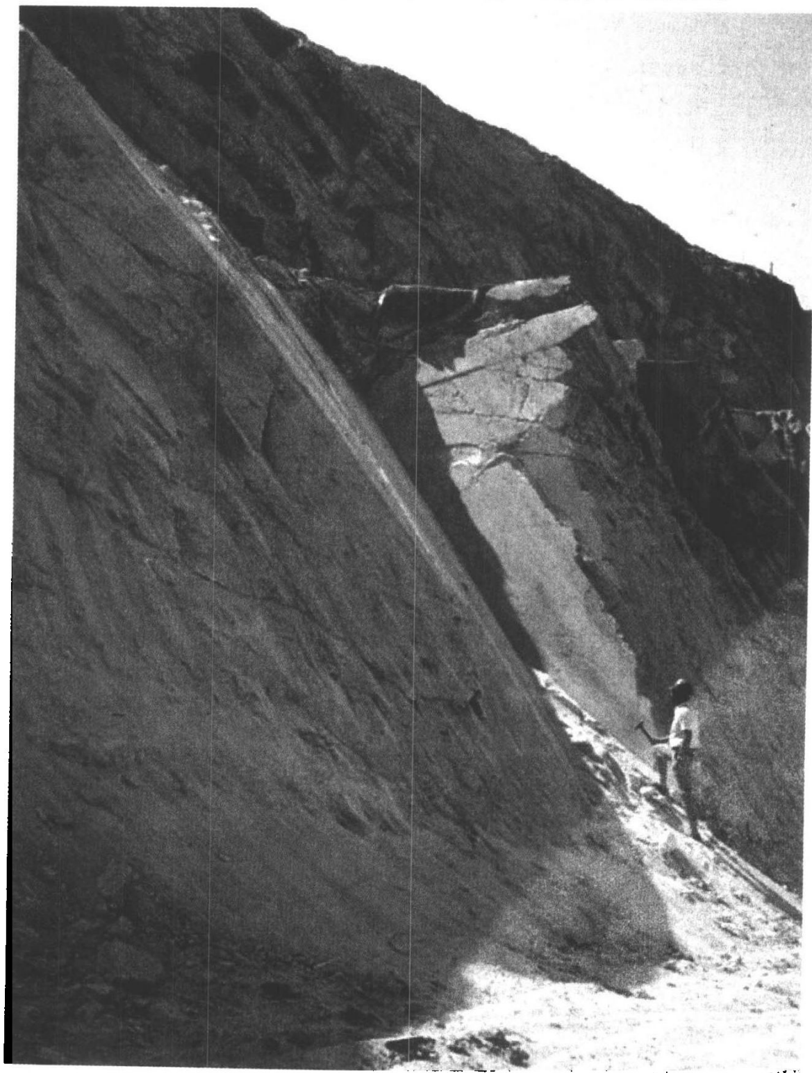
图 1-3 在露天矿形成的台阶岩体中由相互交切的结构面控制的楔形体破坏
