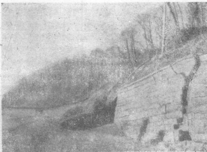
图 2 由于滑坡移动挡土墙的破坏
