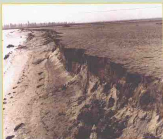
照片 36 上游河道的岸滩崩塌 [11]
