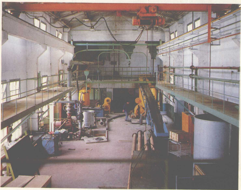
长沙矿山研究院充填管道输送实验室。
