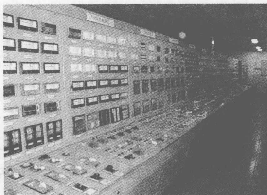
图 1-1 某热电厂锅炉仪表集中控制室
