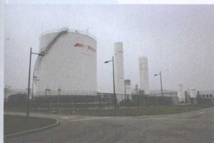
3000m 3 低温液体贮槽
