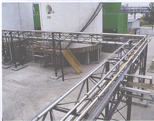
使用中的真空管道
