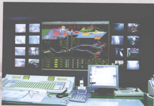
现代化的安全调度控制室
