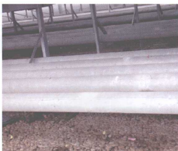
彩图1-14 育苗架床下面的加温管道
