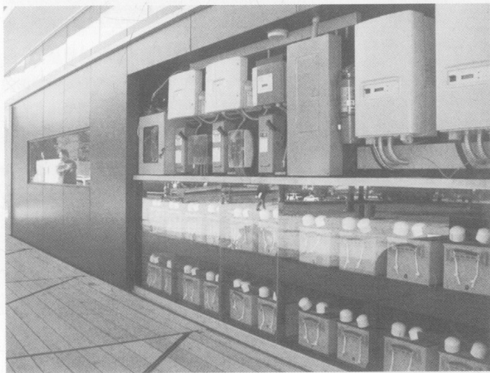
图3 北核心墙外部的房屋整流器、电池组和电子设备,用于太阳能板。为内部空间的布局 and 细节所提供的管理水平和定制水平,与技术设备的水平一致(罗伯特·杜奈拍摄)
