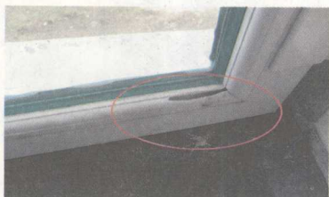
图11 塑钢窗密封压条破损直接导致密封不严
