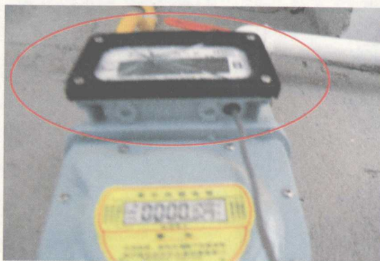
图 49 燃气表玻璃破损
