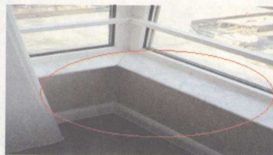
图13 飘窗窗台石材断裂
