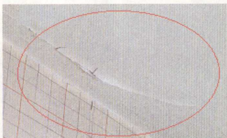
图 28 吊顶涂料起皮开裂
