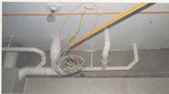
图 47 电线管未固定
