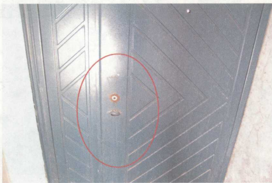
图1 门锁口生锈，无法正常开启
