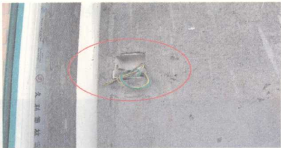
图 40 电源插座距燃气管道过近，存在安全隐患
