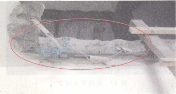
图 37 施工过程中电线导管破损，容易导致短路、漏电，存在安全隐患
