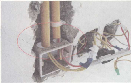
图 45 电线管与接线盒未采用盒接头连接，不便于维修及更换
