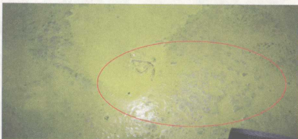
图17 做防水前，地面基层未清理干净，易发生渗漏
