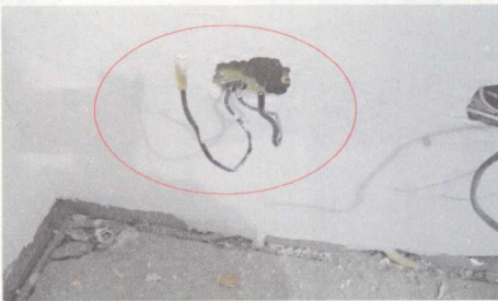
图 43 相线、零线、地线未按电气施工规范分色配线，不易维修
