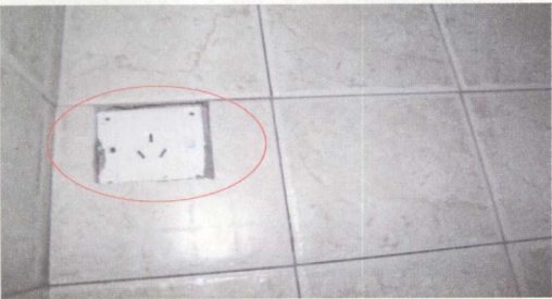
图 42 卫生间插座未采取防溅措施，存在安全隐患
