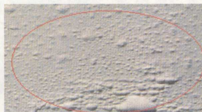
图 27 涂料墙面起泡
