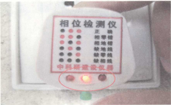
图 38 电源插座缺地线，存在安全隐患
