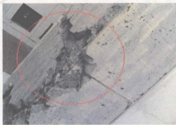
图 23 寒冷地区冬期施工，施工温度低于 5℃，没采取相应措施，造成瓷砖脱落
