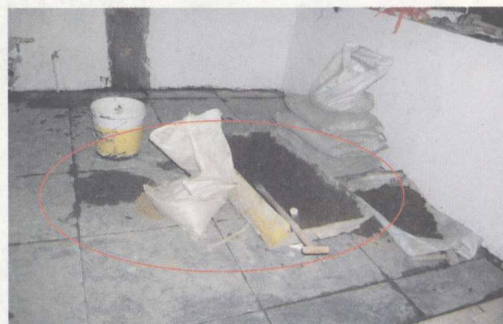
图 21 地砖铺贴后，未采取成品保护措施，导致地砖表面破损
