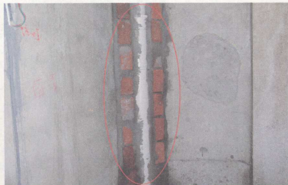
图 33 排水管道砌筑不规范，导致墙砖无法正常粘贴
