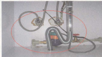
图 34 冷热水角阀安装措施不当
