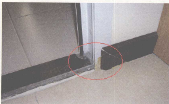
图 52 过门石侧面未抛光，踢脚对接缝隙过大
