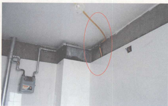
图 50 燃气管道被封于墙内，不便于查找漏点，存在安全隐患
