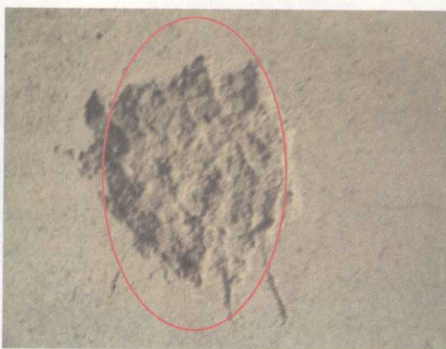
图14 墙面水泥砂浆强度不足导致墙体面层脱落
