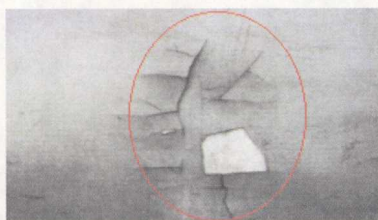
图 25 腻子层、涂料脱落
