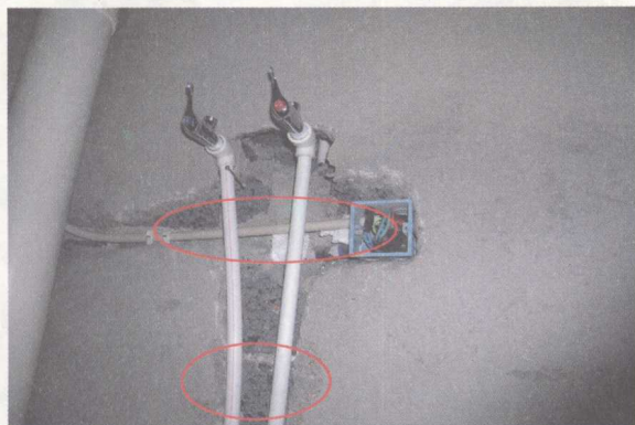
图 32 水电路交叉，存在安全隐患
