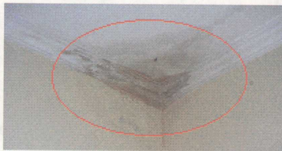
图 51 楼上卫生间防水未做好，造成楼下顶棚污染
