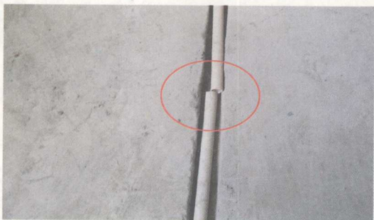
图 46 电线导管没有用管箍连接，以后无法换线
