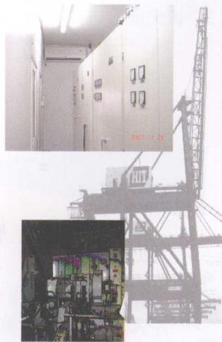
头集装箱装卸桥电气系统改造 CraneScape®
