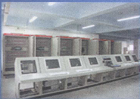
湛江矿石码头扩建工程中控室
