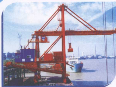
南钢540T/H抓斗卸船机电控系统制造及调试
