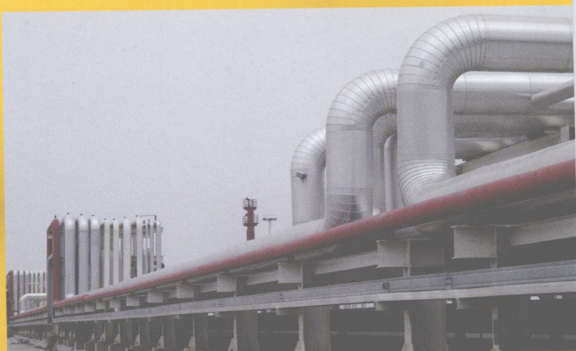
巨龙般的油库码头输油管网使成品油的接卸工作更加方便快捷
