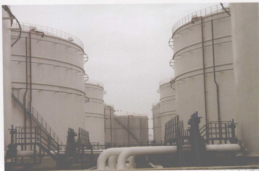
油罐群及与之相配套的输油管道
