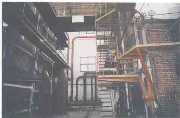
■ 锅炉车间安装有两台上海产10吨四方锅炉（摄于2000年6月）
