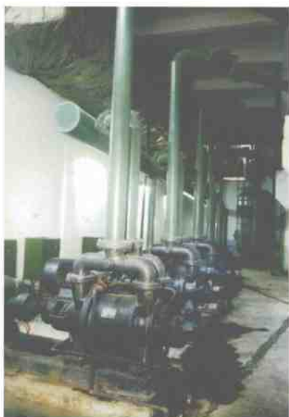
■ 1993年建成的负压集中控制站
