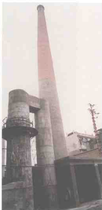
■ 1989年建成的水幕除尘设施
