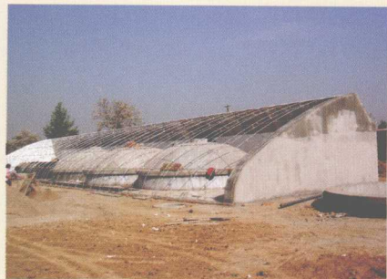
建设中的多级旋动式沼气装置
