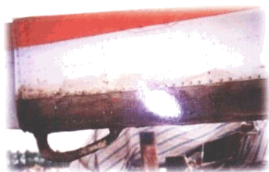
彩图⑬ 后机身尾橇处铆钉 缝腐蚀严重
