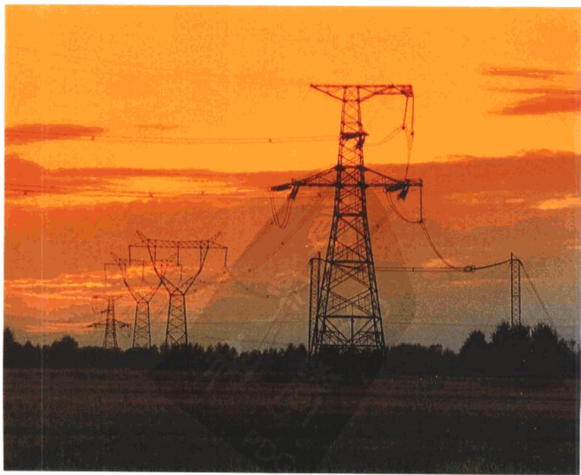
22 万伏输变电线路
