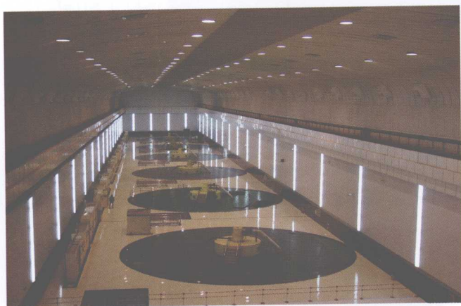
小浪底水利枢纽六台机组全部投产后宽敞明亮的地下厂房(姜拥军 摄)
