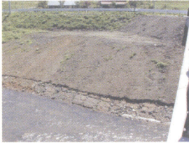
2002年5月棕榈石施工现场的情形。覆盖的土层上，发芽的植物非常少，岸边的覆盖土被流水冲失
