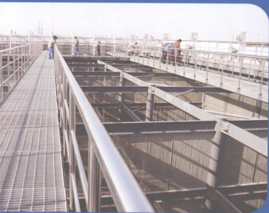
生物预处理调压池
