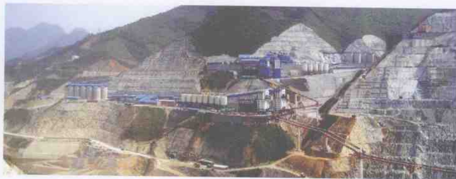
▲ 大坝工程右岸混凝土生产系统
