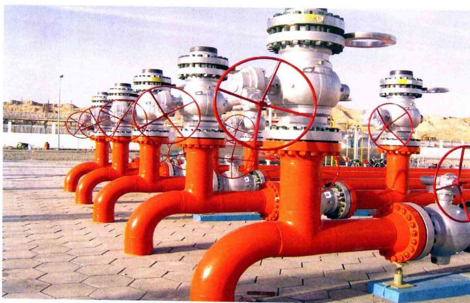
图2 2205 双相不锈钢现场管汇
