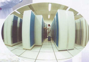
移动通信机房
