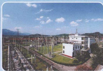
恩施州第一座220千伏变电站——旗峰坝变电所一角。
