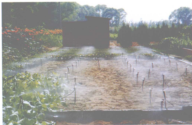
立体高床喷雾 管道系统
