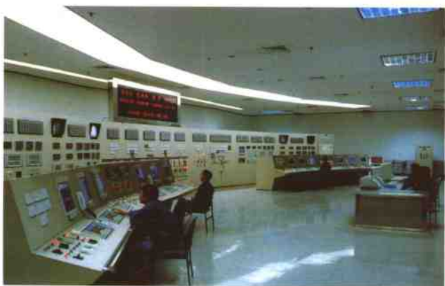
現代化的電廠集控室
