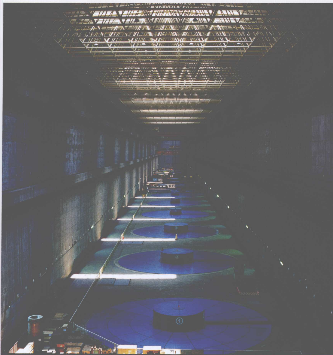
三峡左电站厂房
