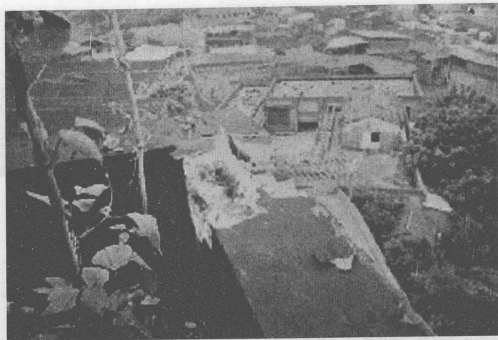
图 1.5(a) 1998 年 5 月重庆市九龙坡区粮食局 30m 高的职工住宅楼雷击女儿墙事故现场
