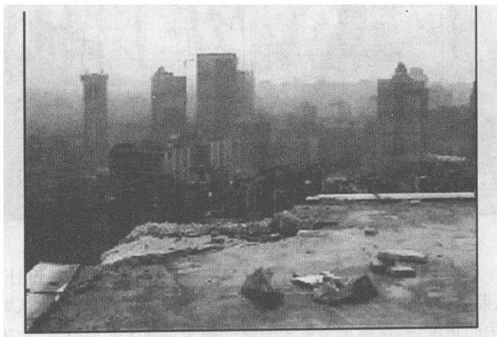
图 1.5(b) 2002 年 7 月重庆市江北区“蔚蓝世纪”75m 高的商住楼雷击事故现场
