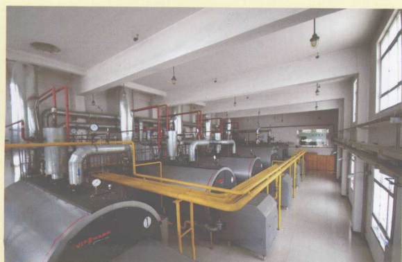
天然气锅炉房
