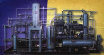
天然气冷却系统
