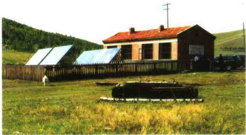
内蒙古华德新技术公司在育良安装的 8kW 光伏供电系统
