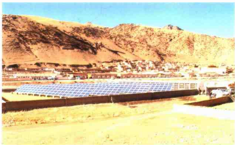
青海省新能源研究所建设的玉树州玉树县下拉秀乡 50kW p 光伏电站投入运行
