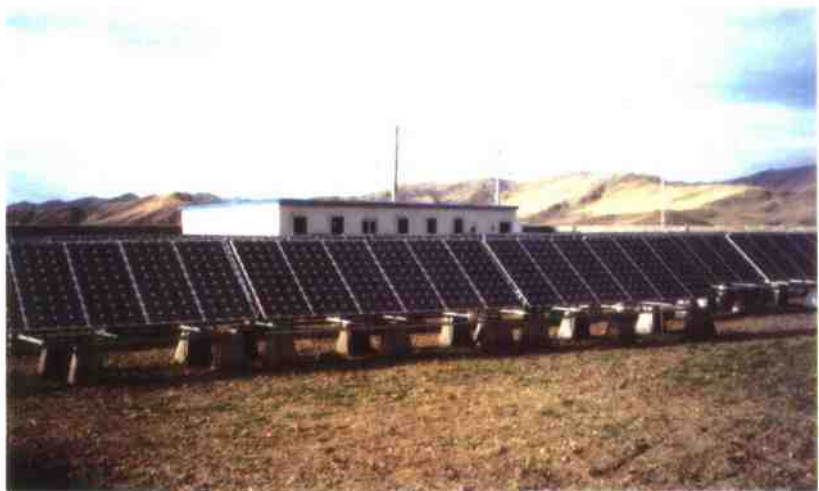
天威英利新能源承建的国家光明工程送电到乡项目
