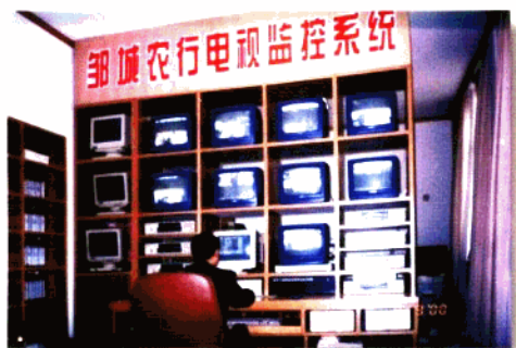
市农行电视监控系统， 使客户储蓄更加安全。
