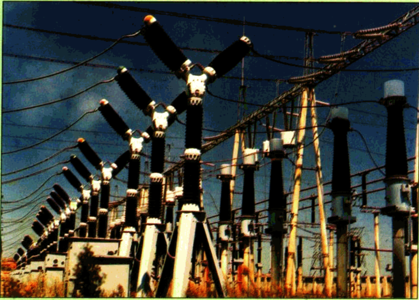
开压站内断路器、电流互感器
