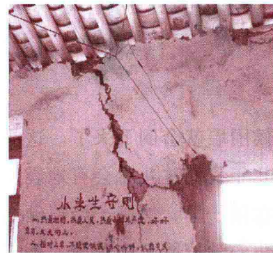
2004年保山市隆阳“10·19”地震时被震裂的教室
