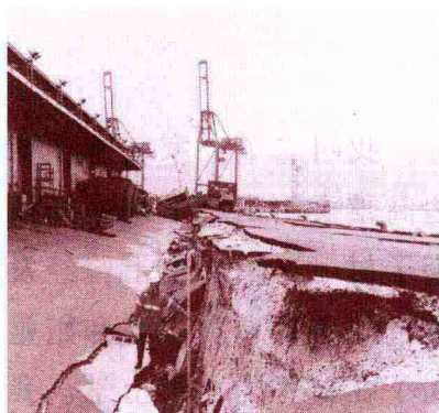
1995年日本阪神地震中被震裂开的公路
