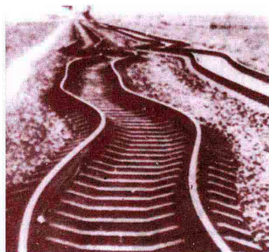
1976年唐山大地震后被震弯的铁路
