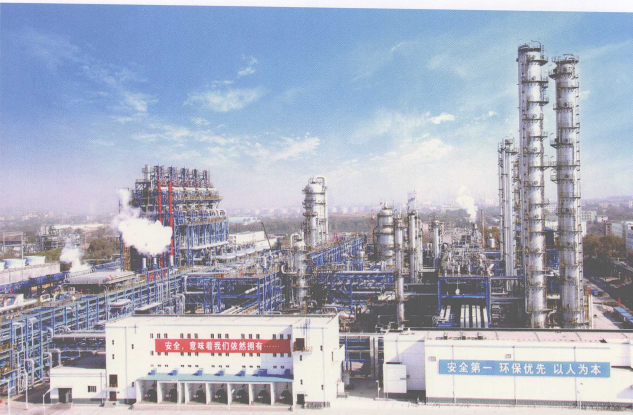
中国石油兰州石化分公司炼油厂年产 70 万吨乙烯装置
