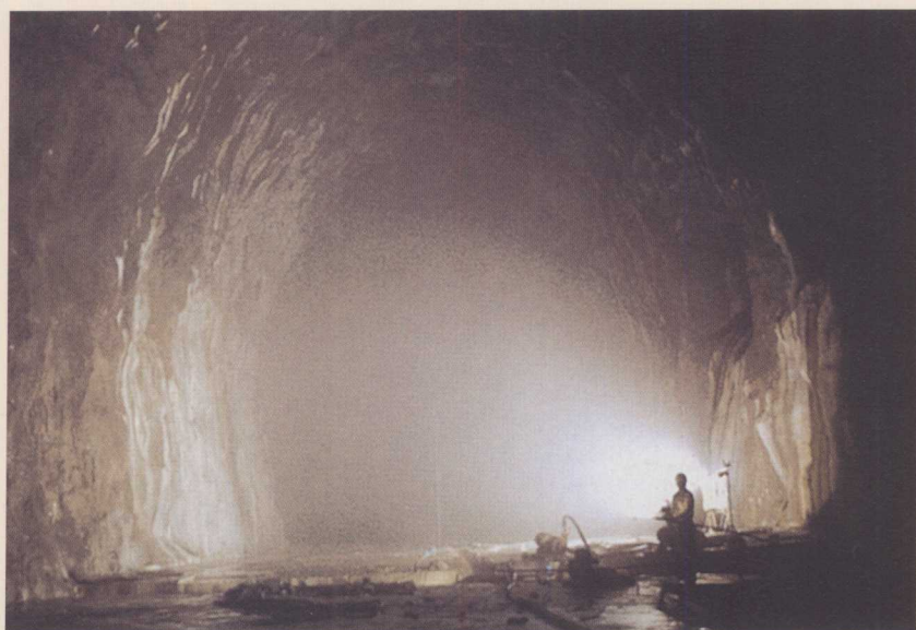
我国第一座海底贮气工程——汕头LPG工程。1997年10月开工，1999年12月建成。
