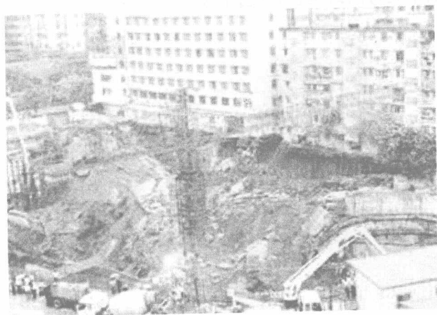
图 1.4 广州某建筑工地挡土墙坍塌
