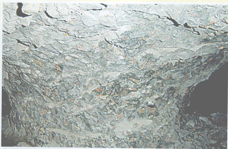
部分截断的桩基
